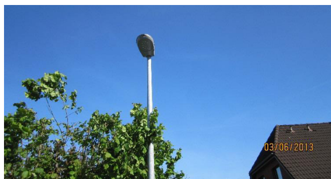
Abbildung 1: Neu errichtete LED Straßenlampe am Hasenberg
